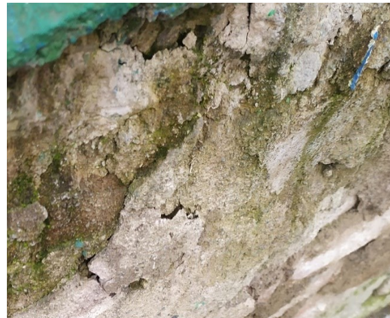
Obr. 29 Pohled na výrazně narušenou omítku. Příčinou narušení je v tomto případě dlouhodobé pronikání vlhkosti, cyklické působení mrazu a působení agresivních látek z vnějšího prostředí (karbonatace).
