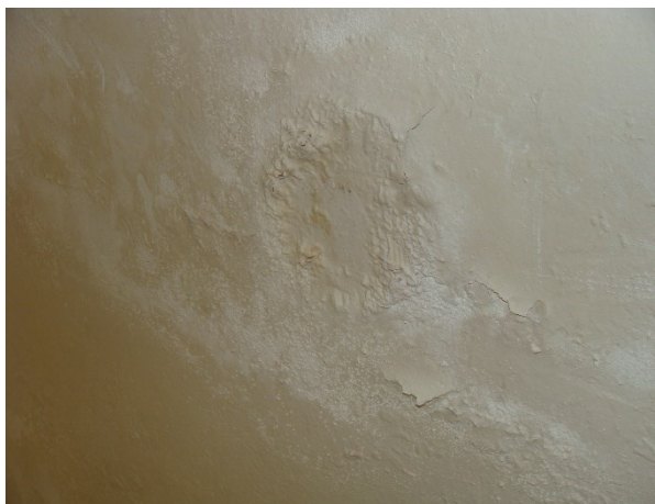
Obr. 8 Pohled na lokalitu, ve které jsou pronikající vlhkostí na povrch stěny transportovány rozpustné soli, kde dochází k jejich krystalizaci.
