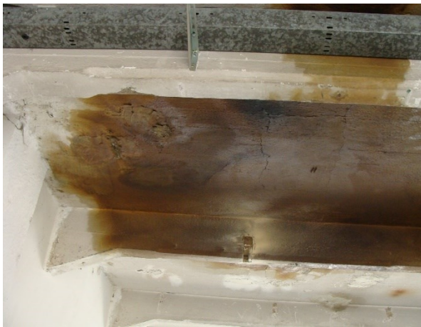
Obr. 18 Pohled na část stropní konstrukce, ve které je pronikáním ropných látek zasažena nejen stropní deska, ale i stropní trám.
