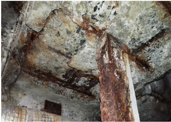
Obr. 6 Pohled na lokalitu, ve které jsou výztužné pruty postiženy extrémní korozi, a masivně je degradován též beton tvořící krycí vrstvu nad výztuží. Na povrchu konstrukce jsou rovněž přítomny inkrustace (výluhy), které svědčí o dlouhodobém a intenzivním pronikání vody a agresivních látek stropní konstrukcí, což akceleruje korozi výztuže. Extrémní korozi je rovněž postiženo ocelové opláštění sloupu.
