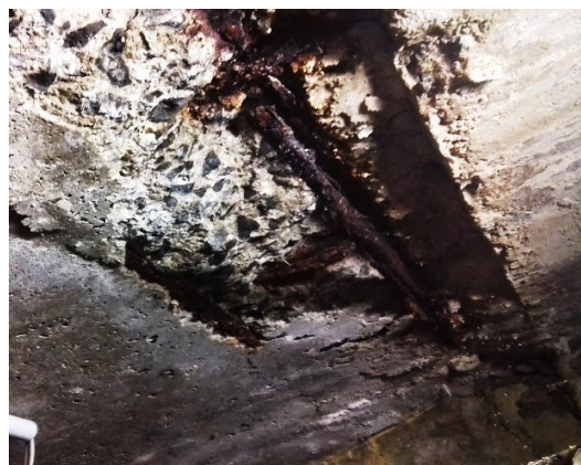
Obr. 5 Pohled na masivně zkorodované výztužné pruty. Objemové změny souvisejí s jejich korozi, jsou příčinou destrukce krycí vrstvy betonu nad výztuží. Narušení krycí betonové vrstvy umožňuje dynamičtější působení kyslíku a vody na výztuž, což korozi výztuže výrazně urychluje.
