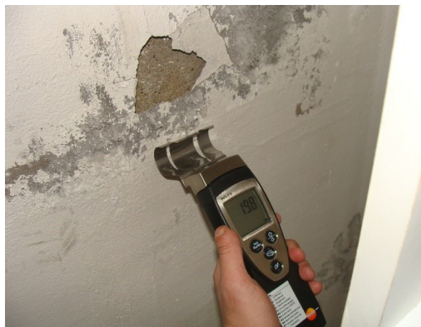
Obr. 21 Nárůsty plísní se vyskytují zejména tam, kde konstrukce vykazuje zvýšenou vlhkost. V důsledku zvýšené vlhkosti v takto postižených lokalitách často dochází k dalším poruchám, jako je např. narušování povrchových úprav apod.
