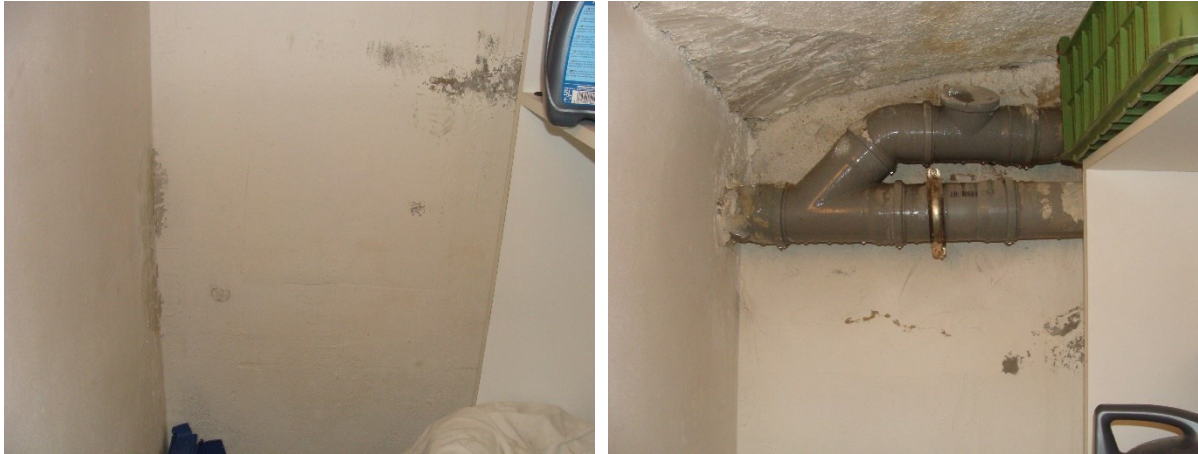
Obr. 22 a 23 Typickými lokalitami, ve kterých se plísně vyskytují, jsou špatně větraná místa (např. kouty a rohy), eventuálně místa, ve kterých je vlhkost stěn zvyšována např. únikem vody z instalací ap.
