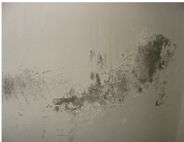
Obr. 20 Pohled na lokalitu, ve které je na omítce přítomný výrazný nárůst plísní. Výskyt plísní v obytných prostorech je z hygienického hlediska nepřijatelný.
