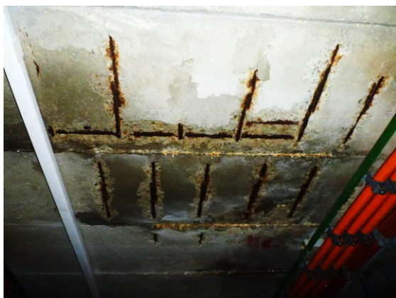
Obr. 4 Pohled na spodní líc stropní desky, u které dochází k masivní korozi výztužných prutů. V tomto případě významnou roli sehrává nedostatečná tloušťka krycí vrstvy betonu nad výztuží.
