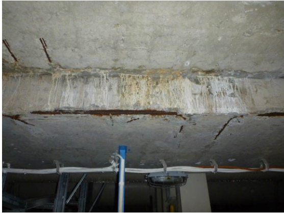
Obr. 10: Pohled na lokalitu, ve které v důsledku pronikání vody na spodním líci železobetonové stropní desky vznikají inkrustace uhličitanu vápenatého a dochází též k masivní korozi výztuže.
