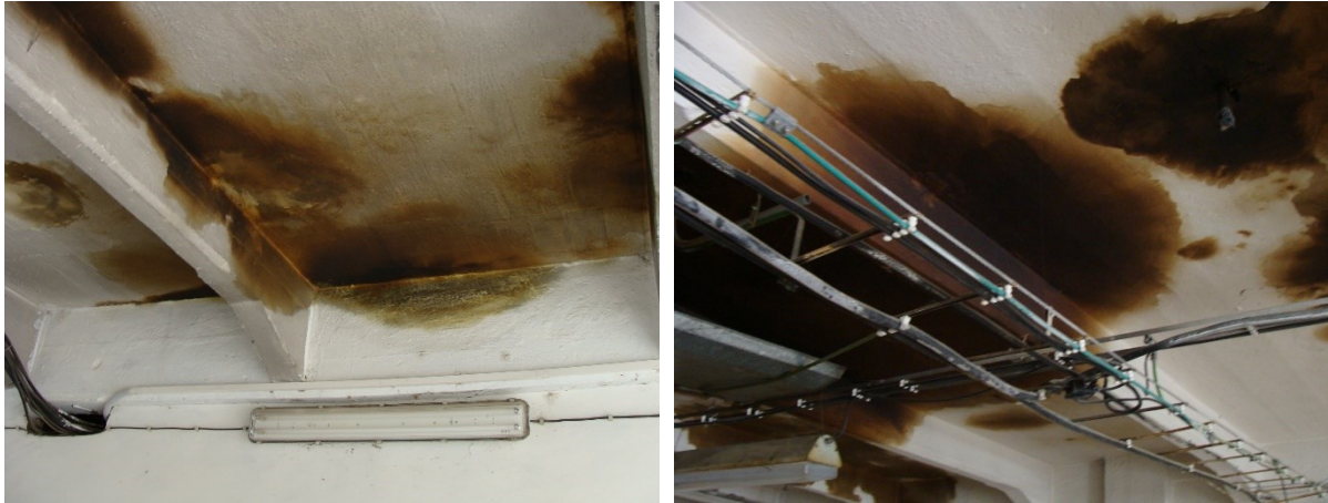
Obr. 16 a 17 Pohled na lokality na spodním líci stropní desky, ve kterých jsou patrné výrazné skvrny svědčící o masivním pronikání ropných látek přes celou tloušťku stropní desky.
