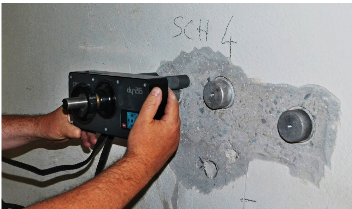
Obr. 32 Provádění zkoušky pevnosti v tahu povrchových vrstev betonu pomocí přístroje DYNA DY-216.
