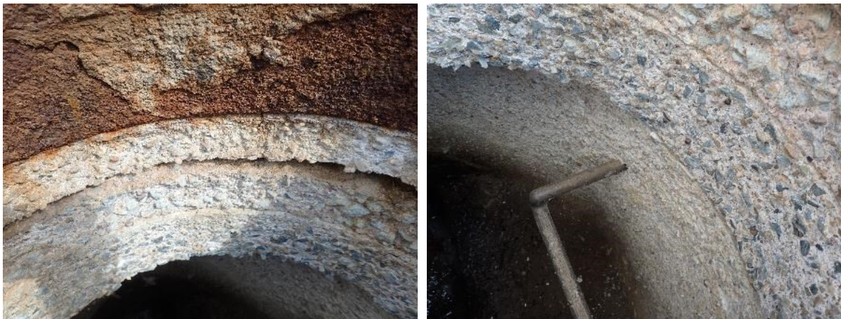
Obr. 24 a 25 Pohled na lokality, ve kterých v důsledku působení agresivních látek vznikajících činností bakterií došlo k degradaci a narušení povrchových vrstev betonových skruží, které tvoří šachty kanalizačních stok. Typickým projevem biodegradace je rozklad cementové matrice a odhalování zrn hrubé frakce kameniva.
