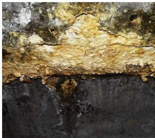
Obr. 9 Krystalizace solí ve struktuře vnitřní hmoty betonu měla v tomto případě za následek destrukci povrchových vrstev stěny.
