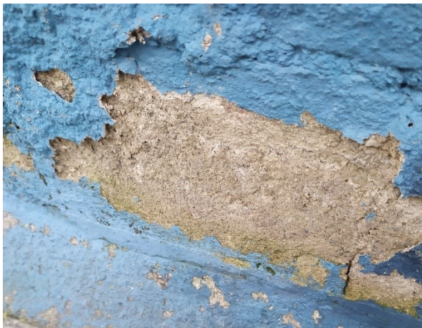
Obr. 28 Pohled na lokalitu, ve které je narušen nejen nátěr, ale dochází i postupné destrukci omítky. Dominantní příčinou destrukce materiálů je v tomto případě synergické působení vlhkosti a mrazu.
