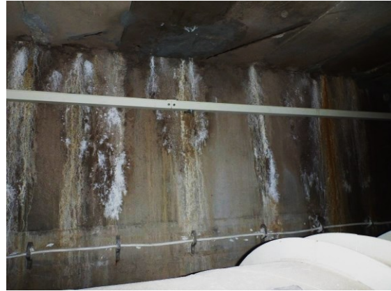
Obr. 11 Pohled na místa, ve kterých ve styku železobetonové stropní desky a stěny dochází k dlouhodobému pronikání vody, důsledkem čehož je intenzivní tvorba inkrustací uhličitanu vápenatého. V některých partiích jsou tyto inkrustace zbarveny oxidy železa.
