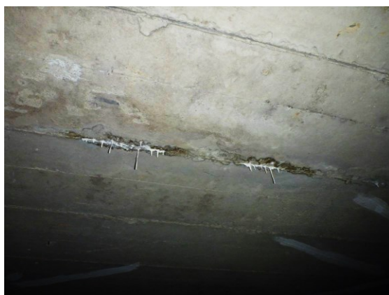
Obr. 14 Pohled na spáru mezi železobetonovými stropními prefabrikáty, kde se v důsledku pronikání vlhkosti tvoří uhličitán vápenatý, který svým habitem připomíná krápníky (tzv. brčka).
