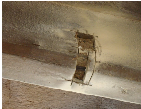
Obr. 19 Pohled na sondu provedenou do stropního trámu. Patrné je, že ropnými látkami je intenzivně zasažen nejen povrch trámu, ale i beton v okolí výztuže.
