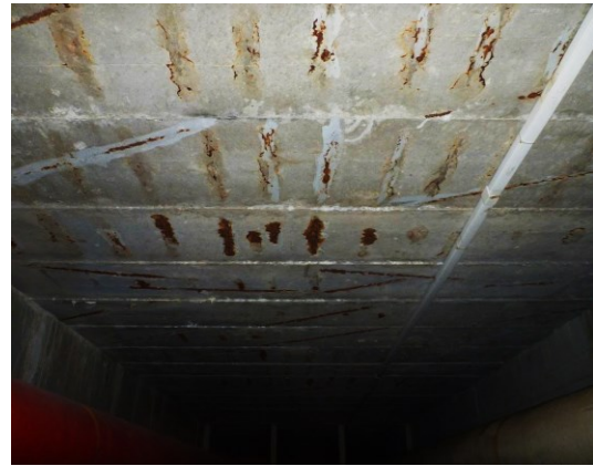
Obr. 7 V některých případech jsou na povrchu konstrukce patrné pouze stopy po pronikání oxidů resp. hydroxidů železitých. Za těchto okolností dosud nedochází k bezprostřednímu narušování krycí vrstvy, jednoznačně však probíhá koroze výztuže a z hlediska další životnosti konstrukce je vhodné přijmout adekvátní sanační opatření.
