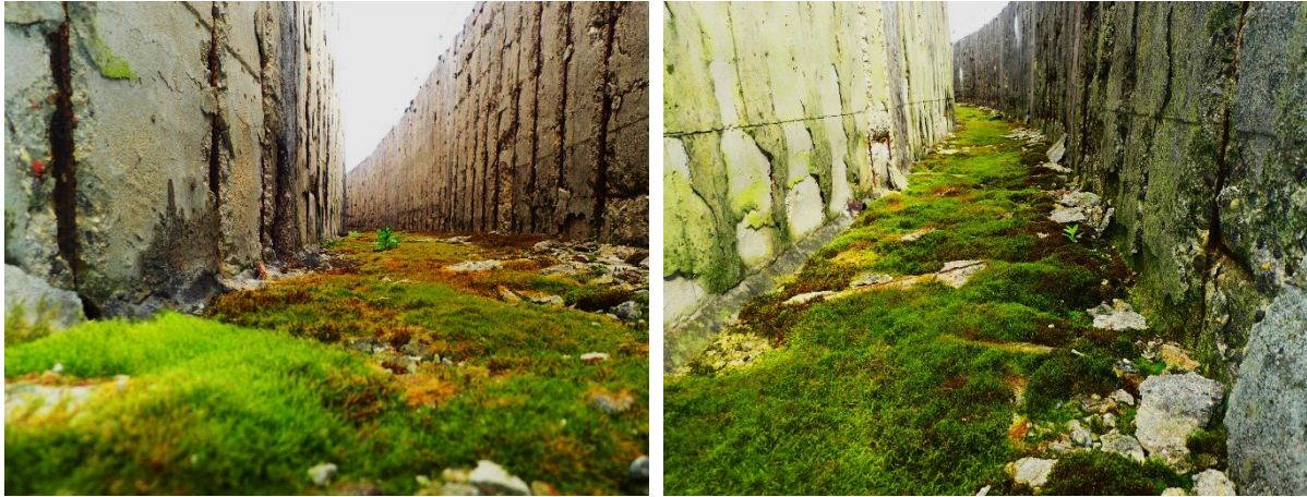
Obr. 26 a 27 Pohled na železobetonovou konstrukci (jedná se o ochoz tahového komína chladicí věže), na jejímž dně je patrný masivní výskyt mechů. V porostu mechů je zadržována vlhkost, která následně v synergii s působením mrazu vyvolává destrukci betonu. Patrná je rovněž masivní koroze výztužných prutů, příčinou této skutečnosti je především nízká tloušťka krycí vrstvy betonu nad těmito pruty.
